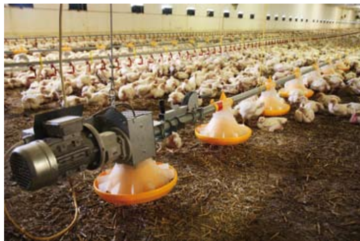
Stáje pro výkrm brojlerových kuřat v Labských Chřčicích prošly částečnou rekonstrukcí, v hale A proběhla kompletní výměna technologie krmení - nová misková krmítka Landmeco s transparentním konusem, včetně rekonstrukce napájecích linek. Haly B až D byly osazeny stmívatelným zářivkovým osvětlením a byly doplněny i o tzv. světla pro chytání (modré osvětlení).
