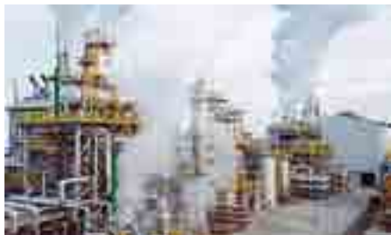
Pohled na jižní část jednotky, v pozadí kompresorovna se třemi turbosoustrojími ve fázi najíždění turbín.
